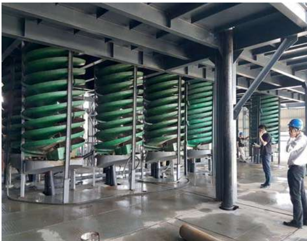
Rys. 6.6. Instalacja spiralnych separatorów służących do wzbogacania piasków granatu [6.34]
